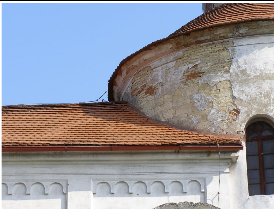
Detail vrchní partie lodi rotundy na jihozápadě s patrným kvádrovým lícem románského zdiva završeného nižší řadou s nepravidelným lícem náležející odsekané románské říms, nad níž se nachází cihelné zdivo navýšené v 70. letech 19. století. Foto: Jaroslav Skopec 2009.
